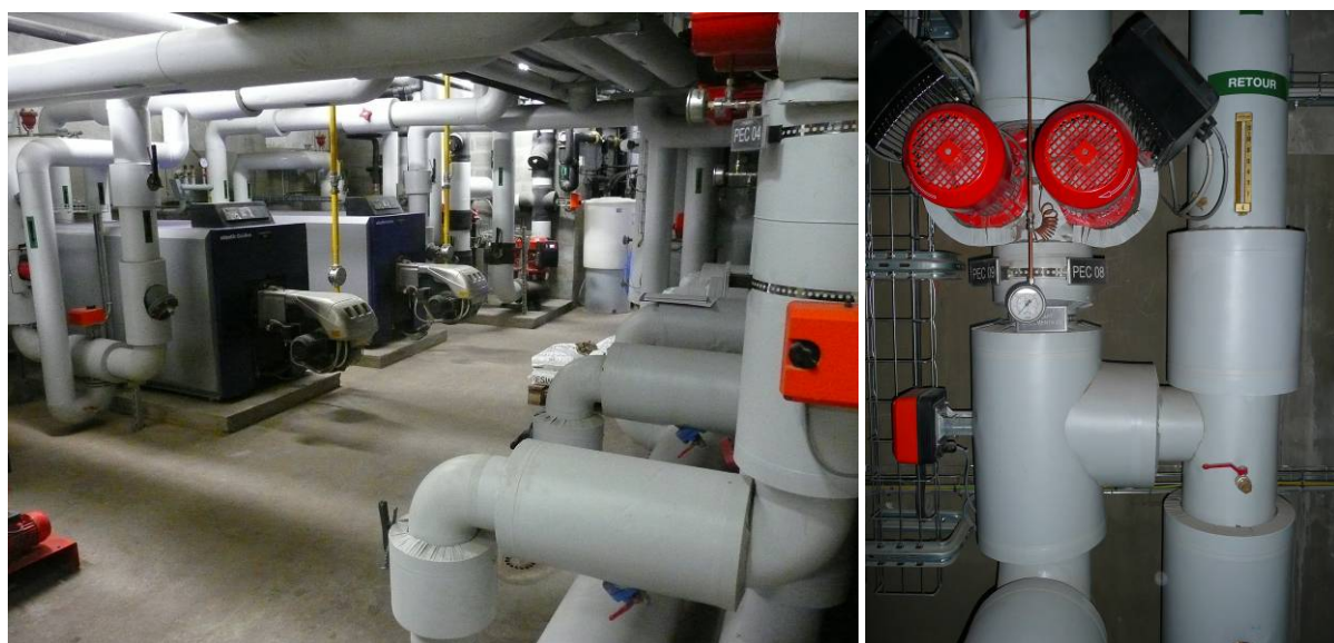
Figure 5.3.4 : Isolation des tuyauteries et composants en chaufferie
