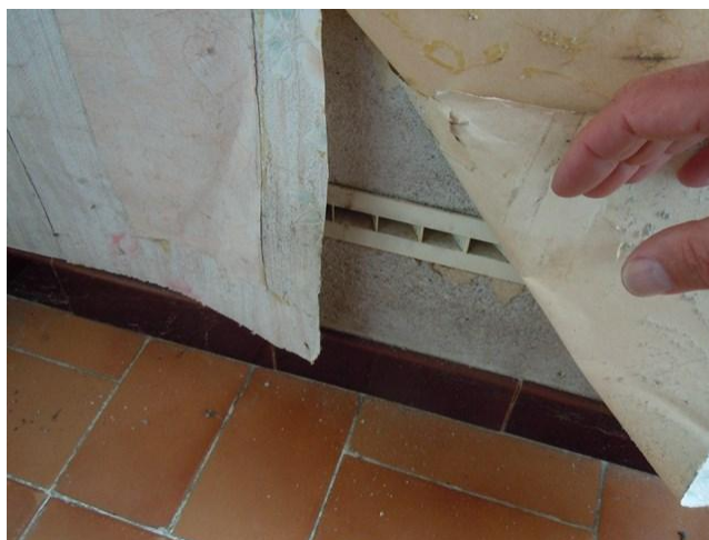
Figure 21 : Exemple de grille de ventilation naturelle cachée par le papier peint
