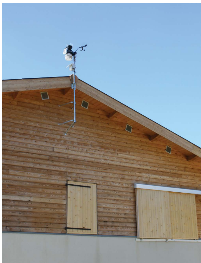
Station météo sur la toiture de LowCal
