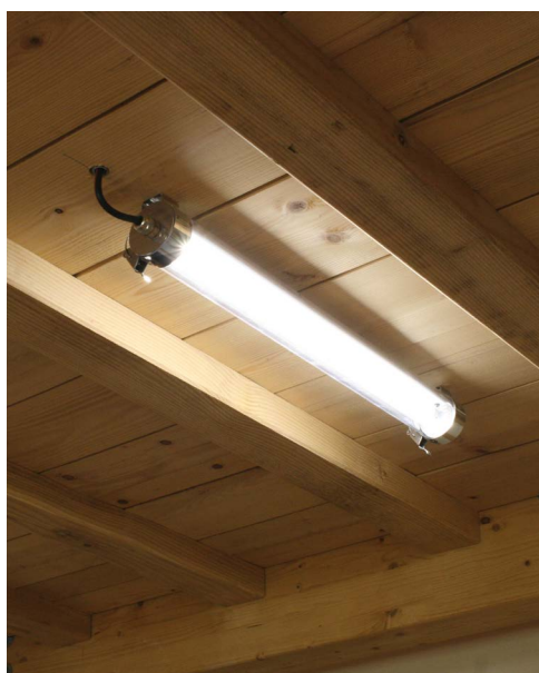
Luminaires d'un bureau
