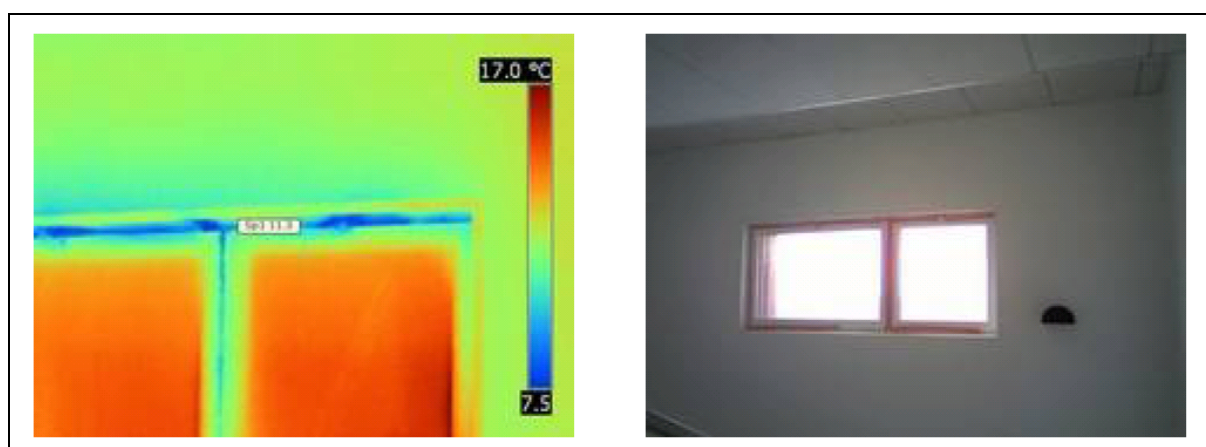
Figure 2.5 : Illustration des fuites au niveau des soufflets des menuiseries (escaliers)
