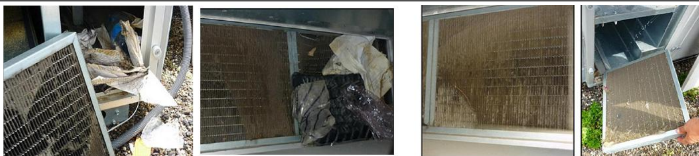
Figure 2.5 – Illustration des principaux défauts de maintenance – Colmatage des prises d'air neuf et encrassement du filtre
