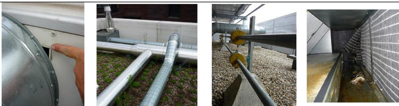
Figure 2.4 – Illustration des principaux défauts de mise en œuvre – Inétanchéité du réseau aéraulique, défaut d'isolation des gaines et des conduits d'alimentation des batteries de préchauffage, accumulation d'eau croupie sur le circuit de soufflage
