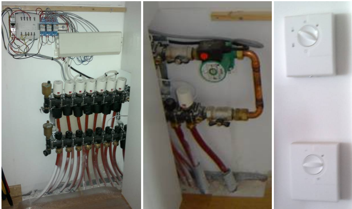
Figure 5.1.13 : Régulation du chauffage de chaque logement (à gauche : répartiteur avec moteur de zone par pièce, au milieu, circulateur d'homogénéisation, à droite en haut : thermostat général d'appartement, à droite en bas : thermostat de pièce)
