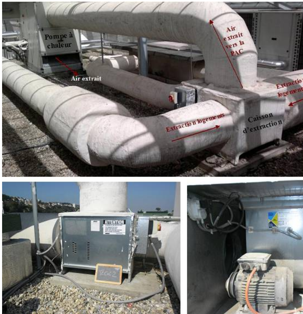
Figure 4.1.3 : Photos des caissons et ventilateur d'extraction
