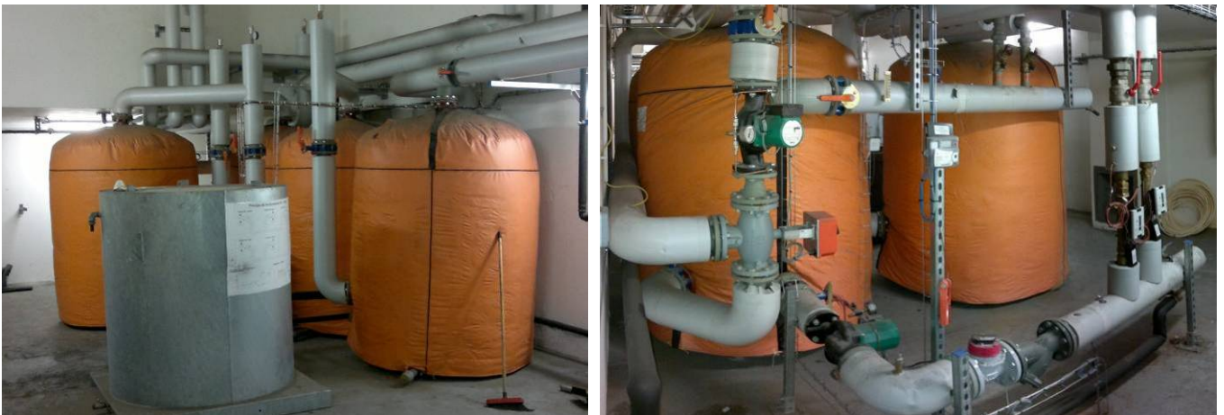
Figure 5.1.3 : Ballons tampon et départs réseaux Nord et Sud
