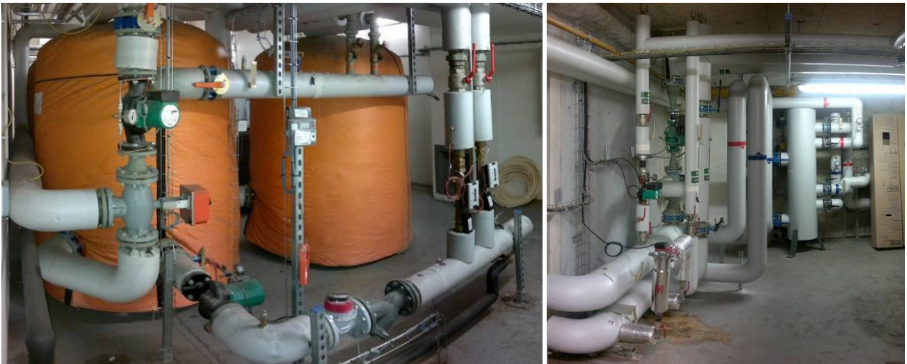
Figure 9.1 : Exemples d'isolations à compléter (chaufferies bois et gaz)
