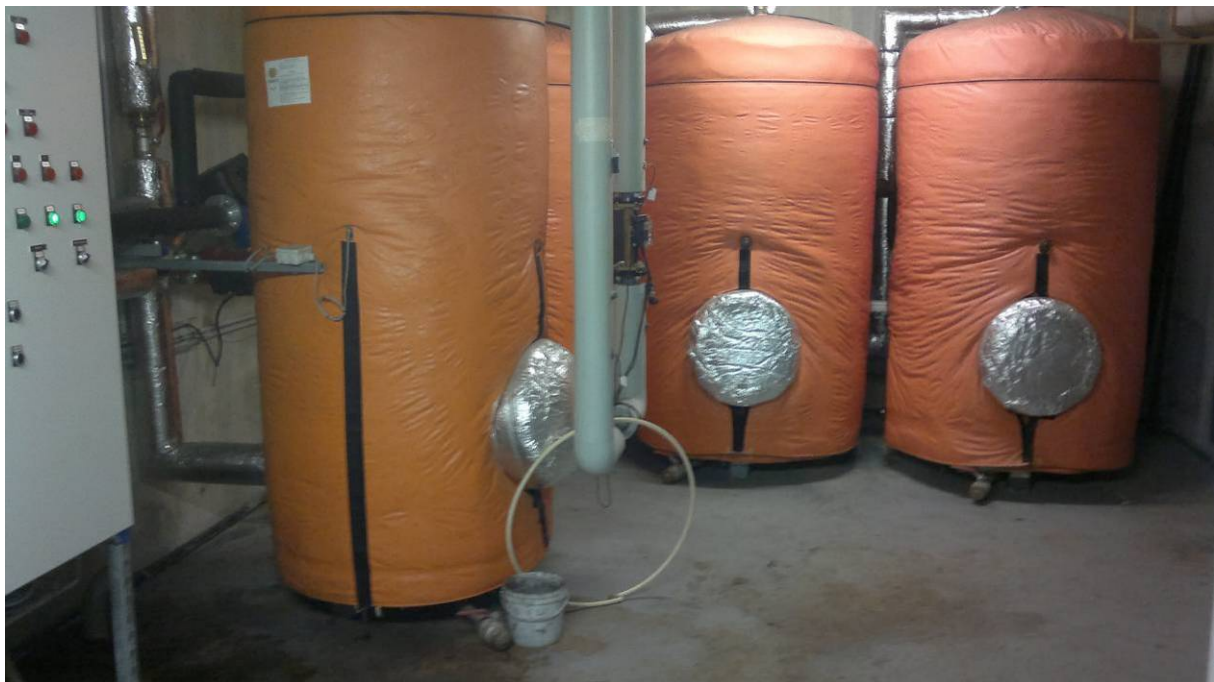
Figure 5.1.5 : Ballons de stockage d'eau chaude sanitaire
