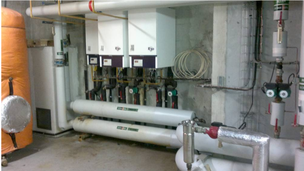
Figure 5.1.4 : Chaudières gaz à condensation dans chaufferie d'îlot
