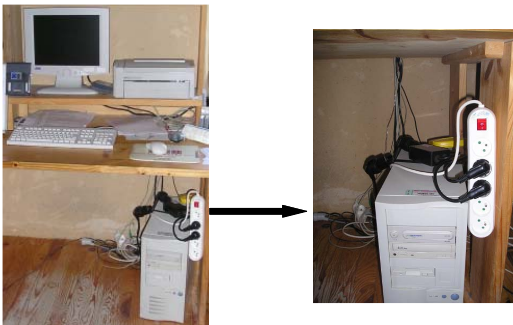
Figure 2.1 : Ordinateur (écran + unité centrale) alimenté par une barrette multiprise
