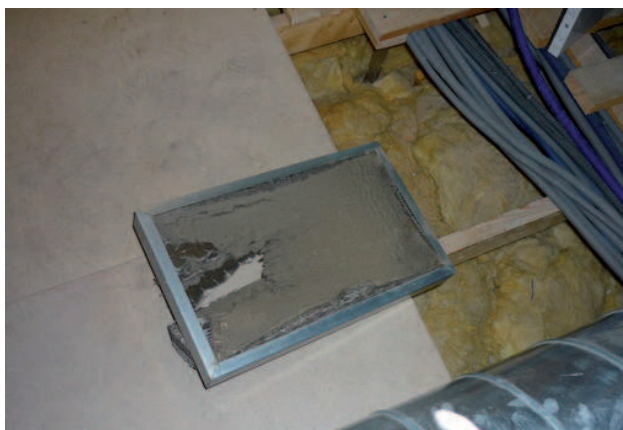
Figures 6 et 7 : filtres détruits par sur-encrassement
