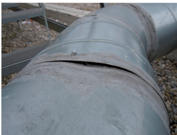
Figure 3 : assemblage de conduits de ventilation « très peu étanches »
